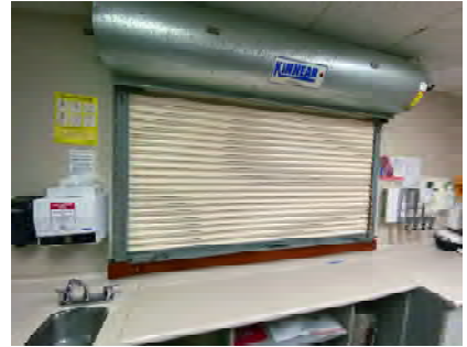
INT012 - Bar Fire Shutter
